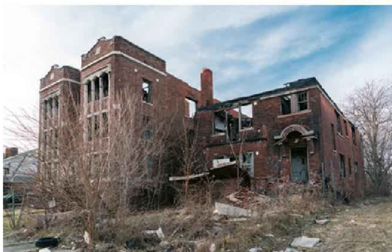
W Detroit znajdują się opuszczone budynki dawnych zakładów przemysłowych, a także zniszczone budynki mieszkalne, często uszkodzone podczas zamieszek.
