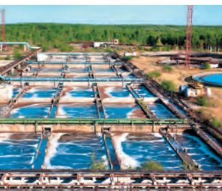
▲ Chemiczne oczyszczanie ścieków
